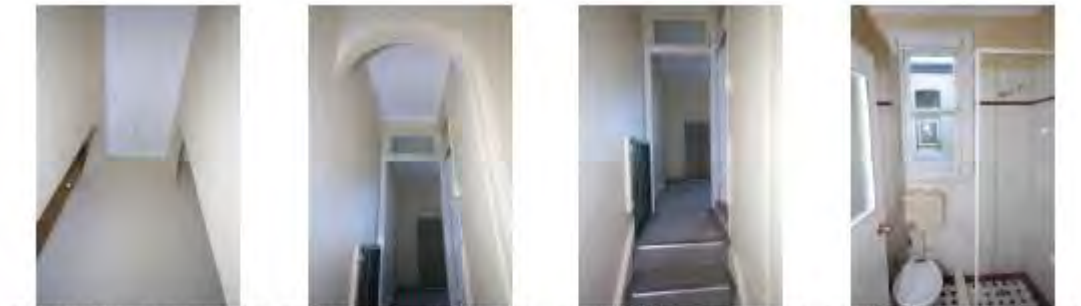
025_36_CAMPBELL_STREET_201 6 f/7.1 ISO 400 2016/08/15 11:26:46 026_36_CAMPBELL_STREET_201 6 f/7.1 ISO 400 2016/08/15 11:27:03 027_36_CAMPBELL_STREET_201 6 f/7.1 ISO 400 2016/08/15 11:27:05 028_36_CAMPBELL_STREET_201 6 f/7.1 ISO 400 2016/08/15 11:27:13
